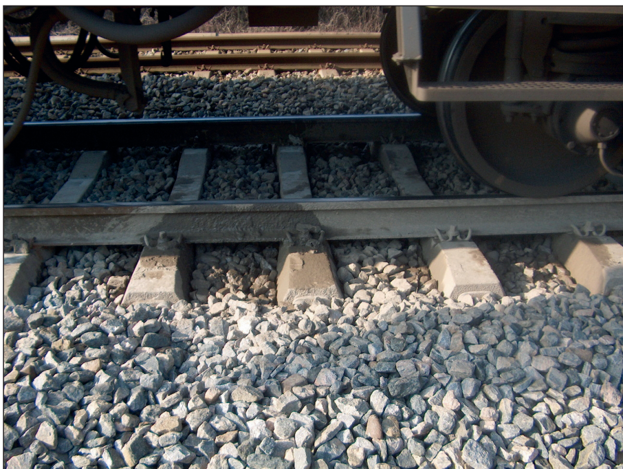
Abb. 1: Spritzstelle im Schotterbett
