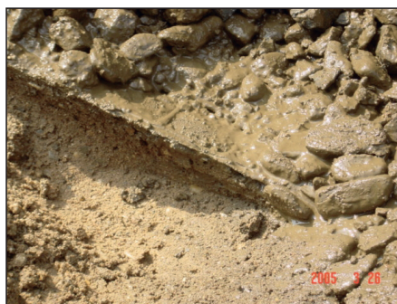
Abb. 2: Schlamm im Schotter auf Grund mangelnder Entwässerung
